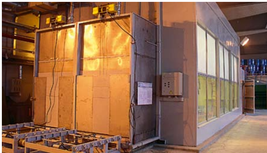
Комплекс по сортировке и фрагментированию отходов Radwaste separation and fragmentation complex
