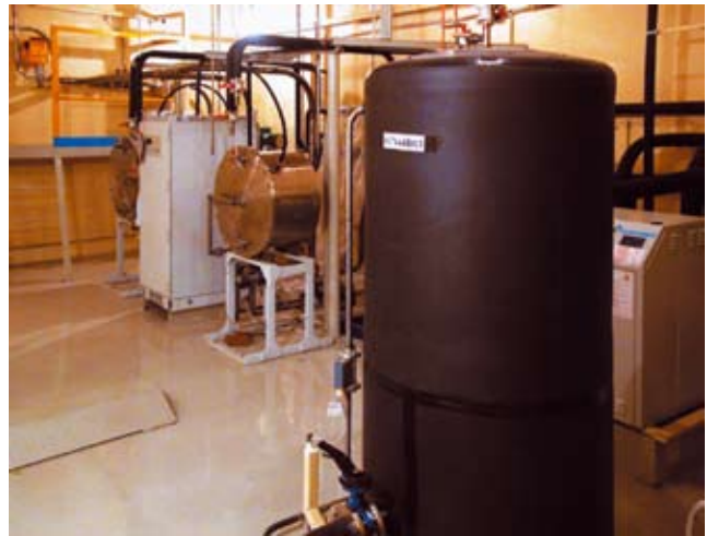
Генераторы озона и система охлаждения комплекса переработки кубовых остатков АЭС
